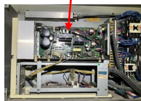
停電時自動着床用 UPS (無停電電源装置)
